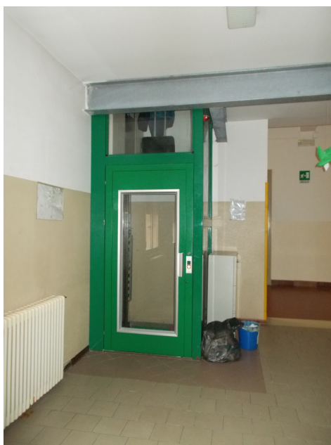
Esempio elevatore interno edificio
